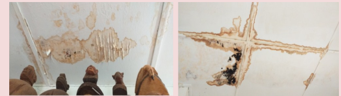
Infiltration d'eau sur les faux plafonds
